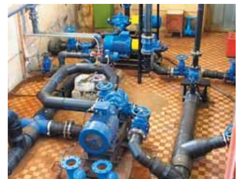
Дубровский водозабор. Станция 2-го подъёма ВОС
